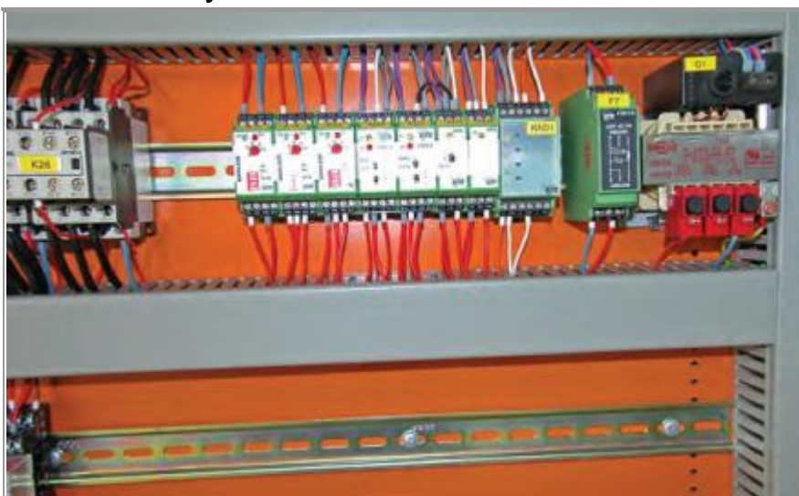
Рисунок 3 – Автоматика на входе газа в горелку
